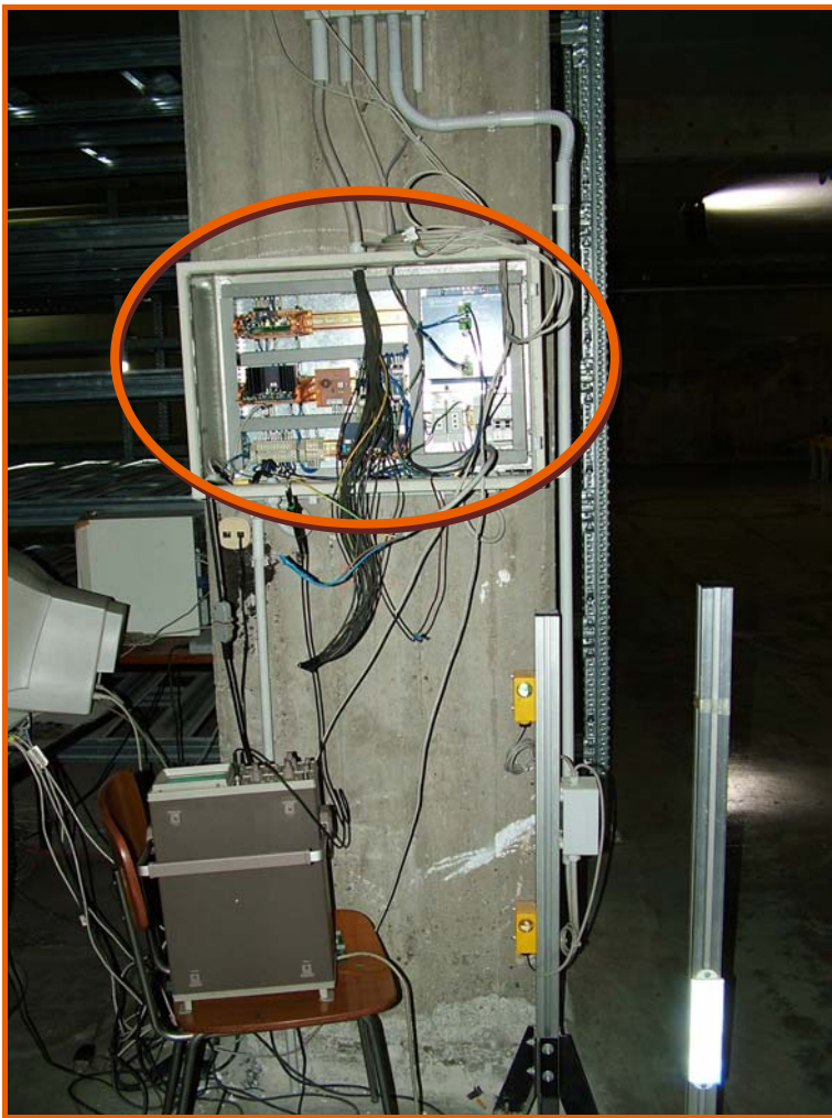
Quadro elettrico secondario al momento dell'infortunio
