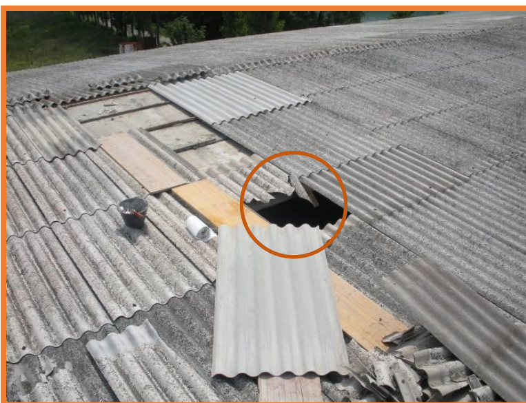
Figura 4: Punto in cui le lastre hanno ceduto (vista dall'alto)
