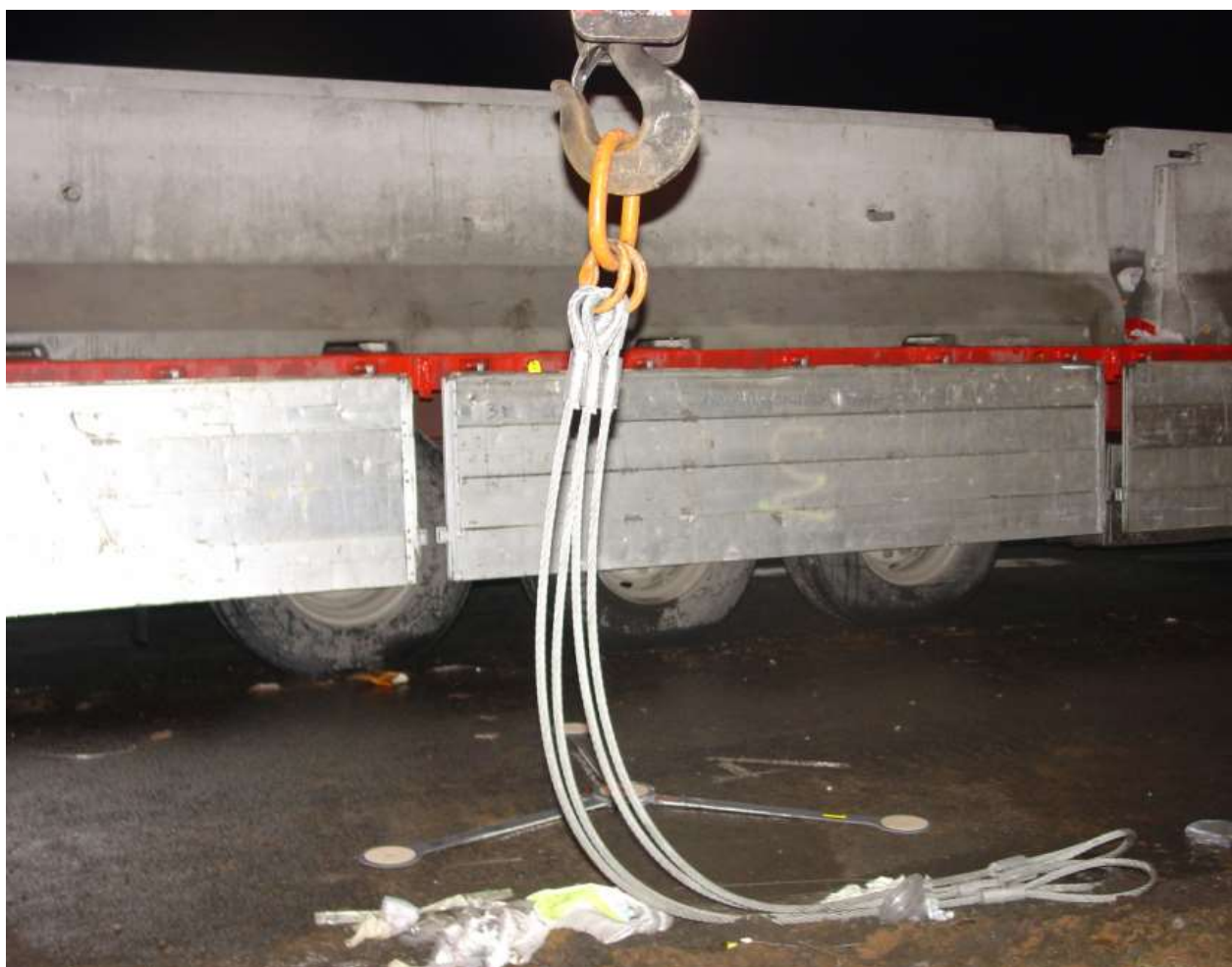
Figura 2. Vista laterale del pianale del camion con le sponde abbassate carico di new jersey da scaricare. In primo piano, particolare del gancio dell'autogru con i cavi di imbragatura ancora inseriti.
