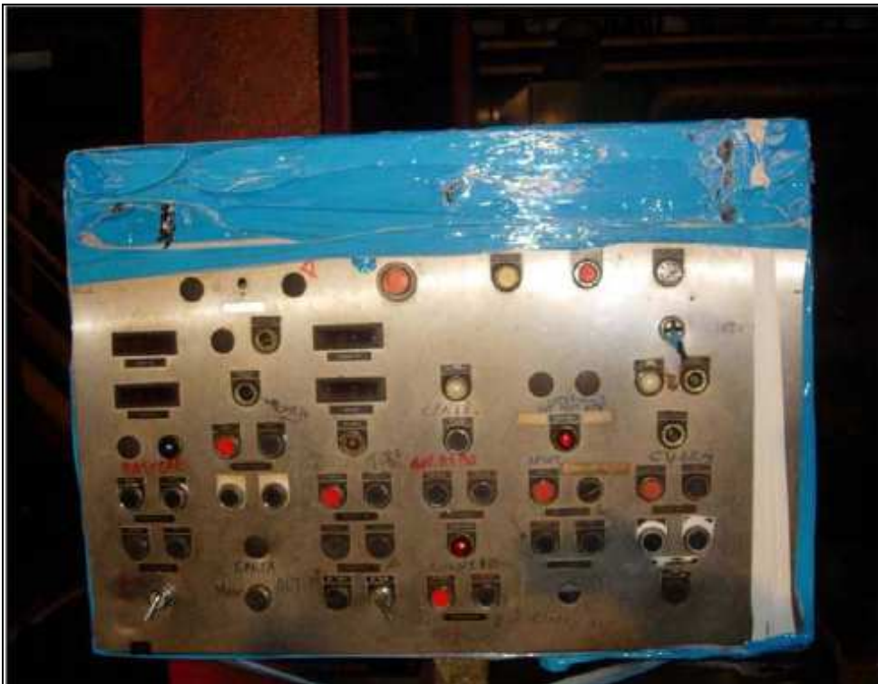
Pulpito di comando dell'aspo 1: sono evidenti le pessime condizioni manutentive
