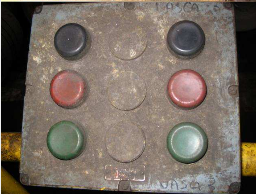
Linea 4, Torino: quadro di comando illeggibile
