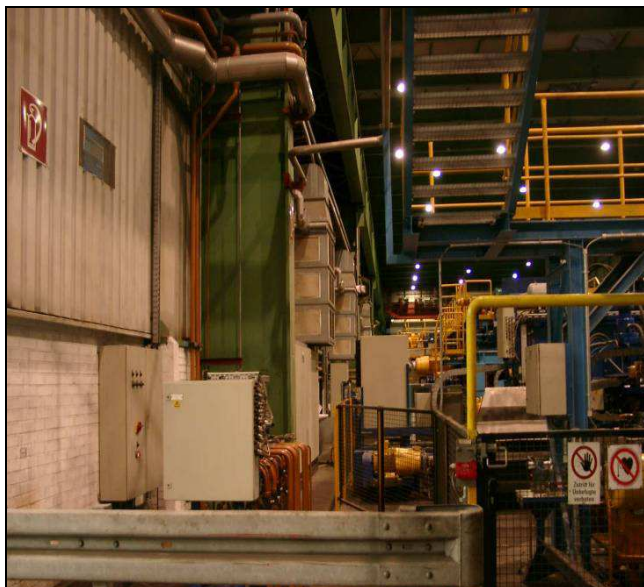
Linea GBL, sala quadri: immagine tratta dal documento relativo al piano di protezione antincendio per la linea KL 3 – incontro avvenuto presso TK Nirosta stabilimento di Krefeld il 23 gennaio 2007
