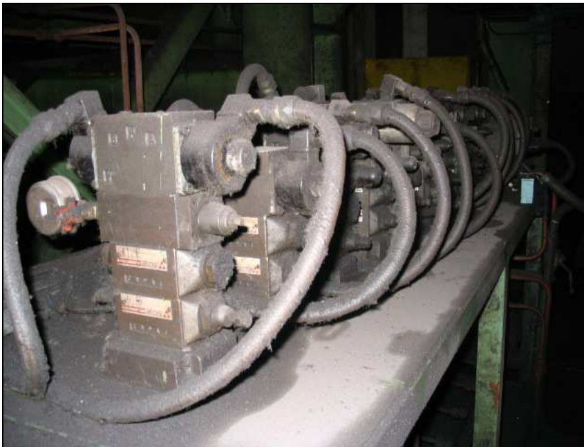
Linea 4, Torino: centraline idrauliche
