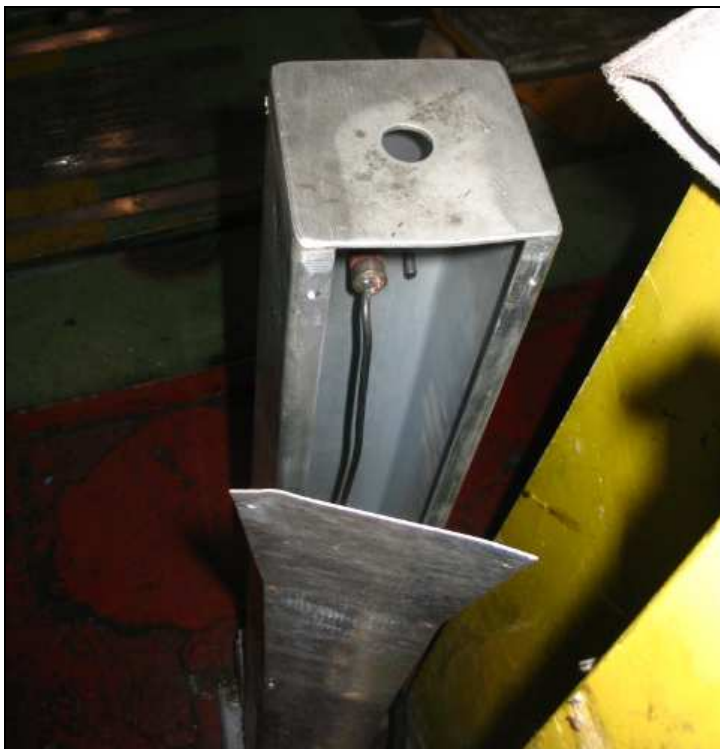
Linea 4, Torino: fotocellula danneggiata
