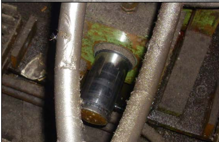
Linea 4, Torino: flessibili idraulici danneggiati
