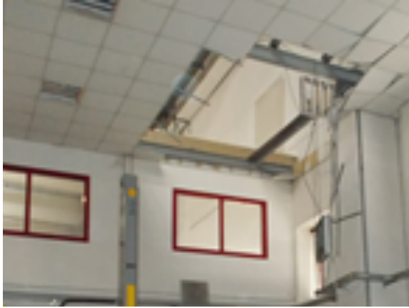
Figura 2: Controsoffittatura del locale “uffici” da cui è precipitato il lavoratore
