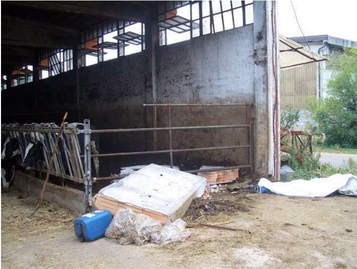
Figura 1: setto in muratura franato
