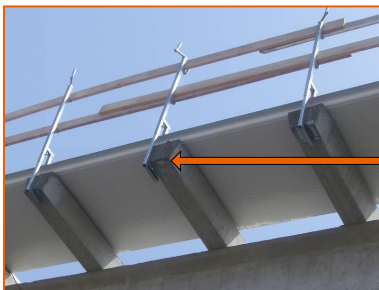
Particolare del fissaggio inadeguato di un montante
