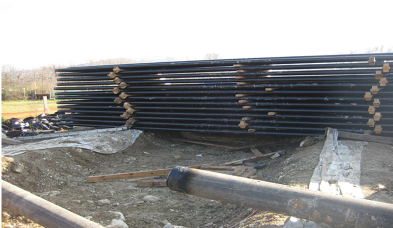
Figura 1: La catasta di condotti realizzata e il tubo metallico utilizzato per la stabilità della stessa .
